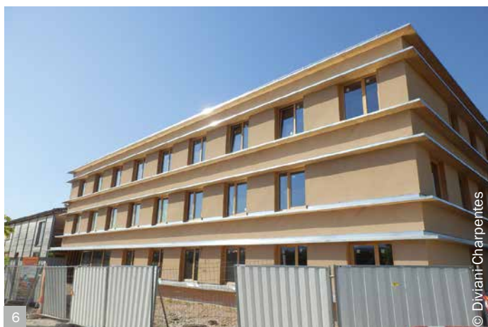
1 et 2. Terrassement et fondations du bâtiment 3. Structure béton nue 4. Structure béton + mur caisson bois/paille 5. Enduit sur façade 6. Enduit de finition sur façade
